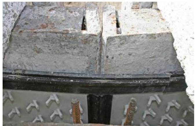
Agru HDPE Sure-Grip® en proceso de montaje previo a hormigonado. Tachos quedarán embebidos en concreto para así tener una estructura solidaria estructuralmente hablando.
